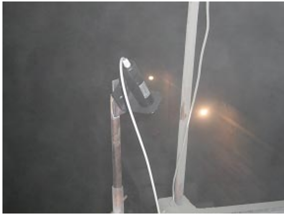
Сухоложский цементный завод, пирометр Термоскоп-200, контроль температуры охлажденного клинкера
