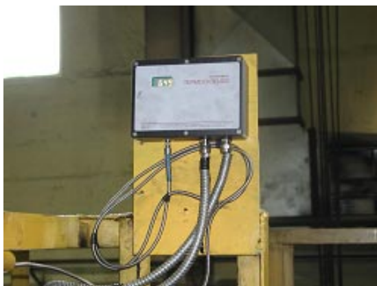
Качканарский ГОК, пирометр Термоскоп-600, контроль температуры шихты в горне агломашины
